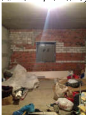
Рисунок . Опасное хранение стройматериалов и старых вещей.
